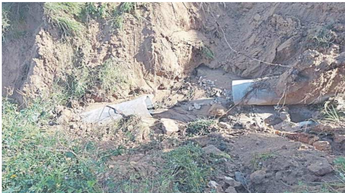
Una imagen de la tubería rota en la estación de bombeo de Fuentebravía.
