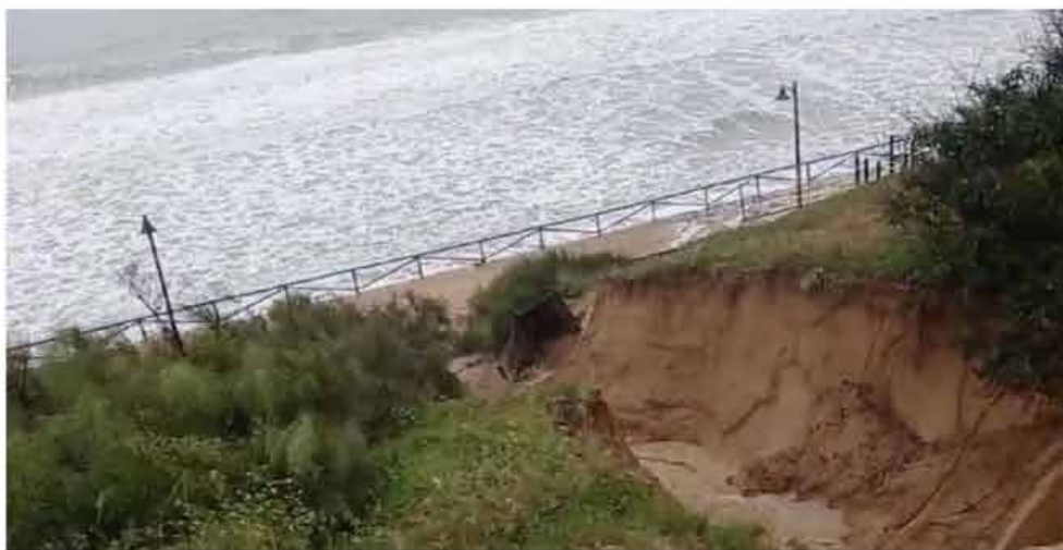
El temporal destroza una tubería de la Estación de Bombeo de Aguas Residuales (EBAR) de Fuentebravía en El Puerto.
