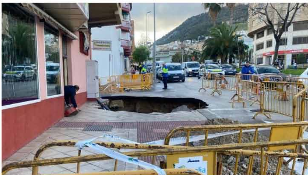
José de la Chica cierra su local tras la apertura del socavón en la avenida Arjona de Jaén.
