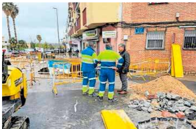
Primera actuación tras producirse el socavón en la avenida de Arjona. I.
