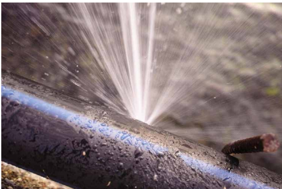
L'origine des fuites qui touchaient le réseau d'eau potable de Nesles-la-Vallée a été résolue par les services de la Sefo. ©Actu.fr
