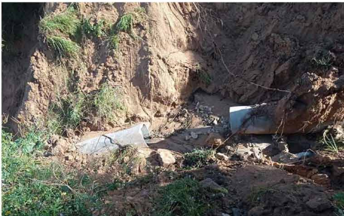
Restos de la tubería afectada / FOTO: Apemsa
